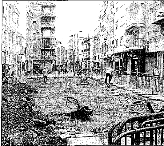
Operarios trabajan en la calle Murcia tras el derribo de las dos casas. / LA VOZ
